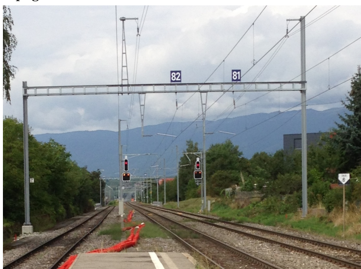
Cliché ci-dessus : de Meyrin en direction de la ZIMEYSA ; la voie de gauche est en réserve.
